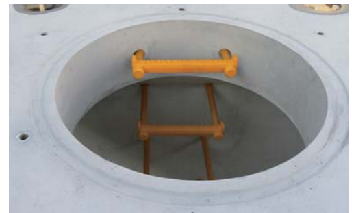
吸管投入孔取り付け位置
