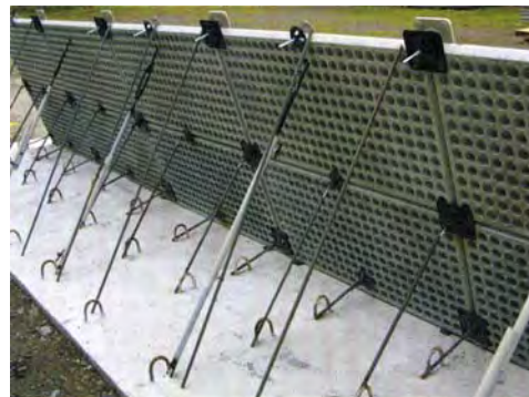
2 専用勾配調整サポート使用状況
